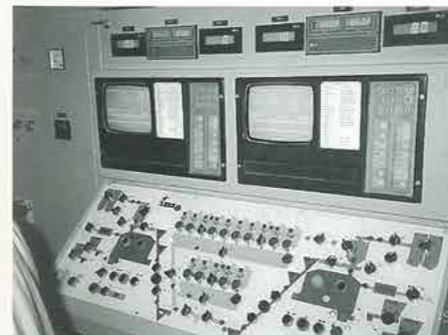
プラント操作室
